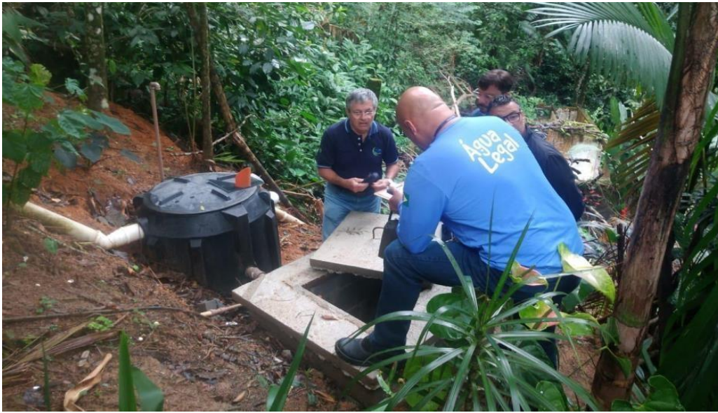
Figura 3 - Instalação do biodigestor em uma residência.
