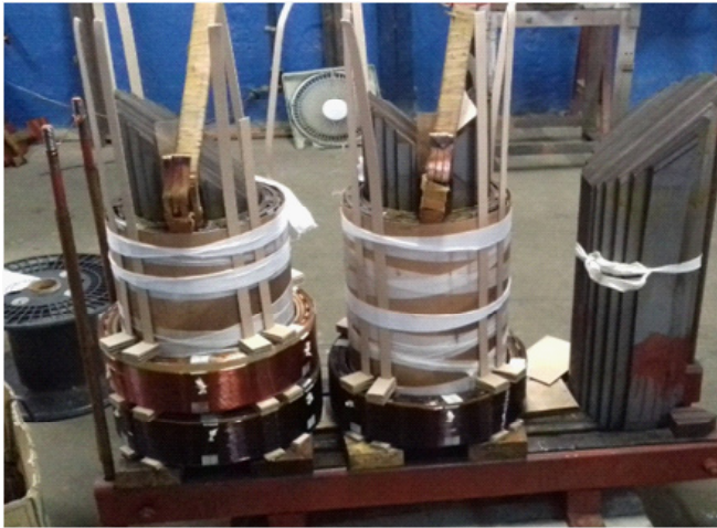
Figura 6. 1ª e 2ª coluna do transformador.
