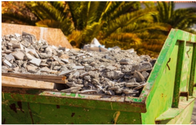
Figura 2. Rejeitos de construção Civil.
